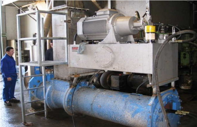
In Spanien aufgestellte Rohmaterialpumpe
